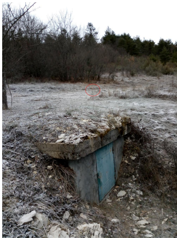
FIGURE 18 – font de Saule : entrée du captage et clairière. Le piquet (ellipse rouge) matérialise l'extrémité du drain
