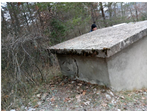
FIGURE 12 – Chambre de réunion Rate et Aiguiers : béton dégradé à l'arrière de la chambre
