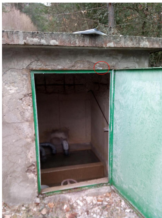
FIGURE 11 – Chambre de réunion Rate et Aiguiers : porte d'entrée non jointive, béton dégradé (trou dans le mur au-dessus de la porte d'entrée)
