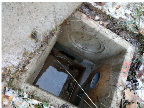
FIGURE 3 – Aiguiers haut : regard de captage
