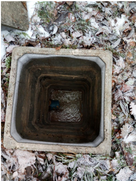
FIGURE 6 – Source de la Rate, captage amont : regard en amont de la chambre de captage
