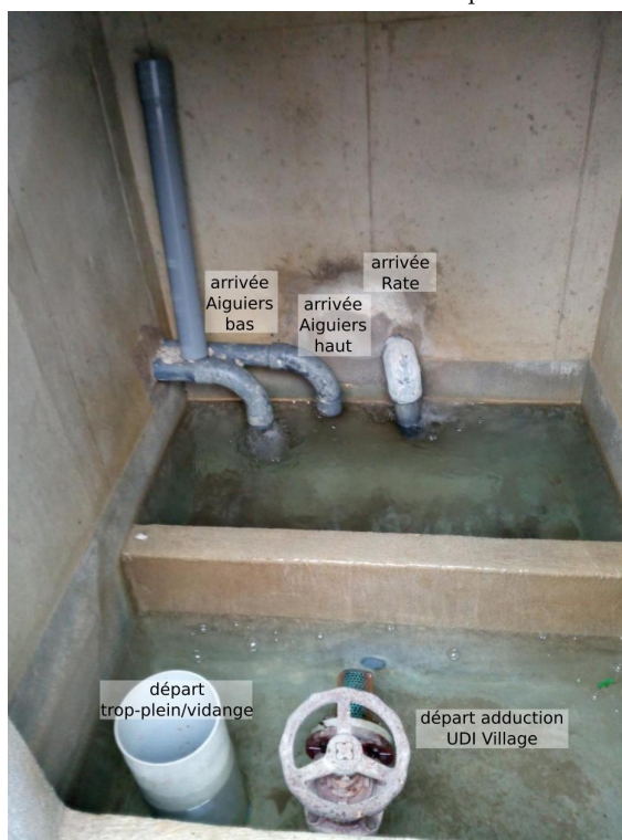
FIGURE 13 – Chambre de réunion Rate et Aiguiers : intérieur de la chambre. Sur la partie supérieure de la chambre les fers à béton sont apparents.
