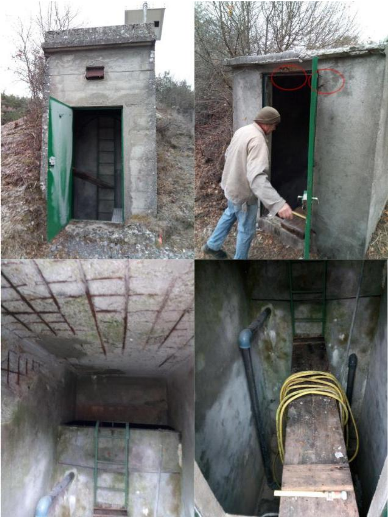
FIGURE 16 – Réservoirs des Clôts : extérieur du réservoir 1, extérieur et intérieur du réservoir 2. Les deux bâtiments sont conçus suivant le même modèle.
