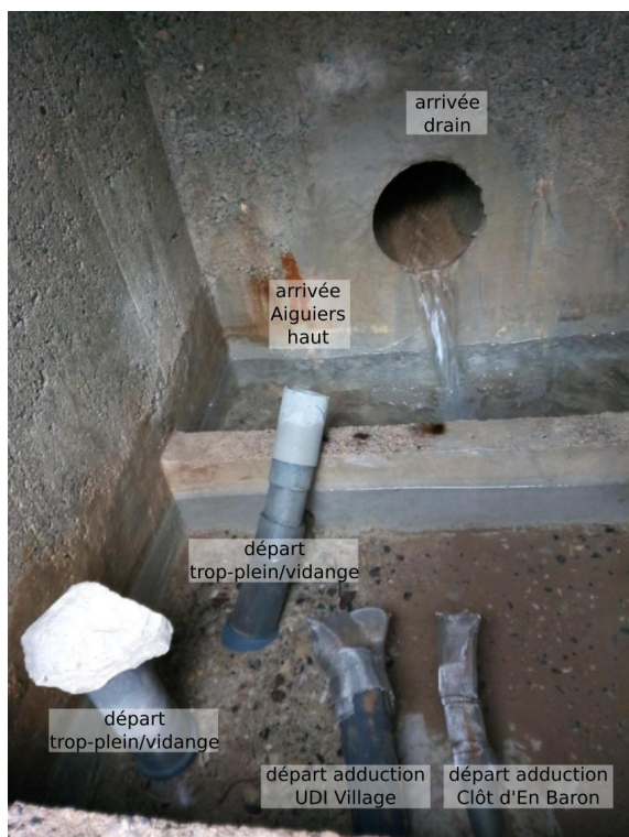
FIGURE 8 – Source de la Rate, captage amont : intérieur de la chambre de captage
